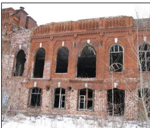
Фото.5. Фрагмент 2-этажной части дворового фасада. Многочисленные разрушения кладки стен в результате климатических воздействий.
