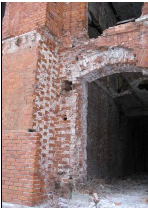
Фото.3. Разрушение наружной версты кирпичной кладки дворового фасада.
