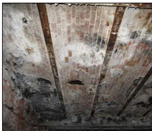
Фото.6. Перекрытие первого этажа. Сырость и плесень на потолке, разрушения кирпичной кладки сводов, коррозия металлических балок.
