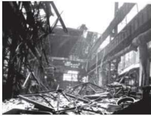
Рисунок 2. Обрушение покрытия электросталеплавильного цеха на заводе ОАО «Пензтяжпромарматура» в Пензе [2]
