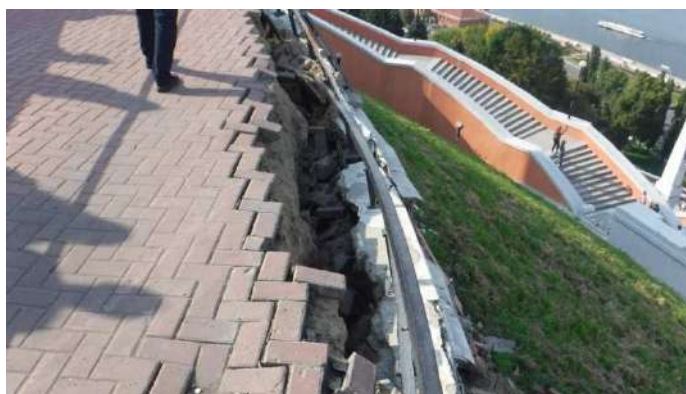
Рисунок 1 – Обрушение парапета и брусчатки Чкаловской лестницы, Нижний Новгород. 2022 г.
