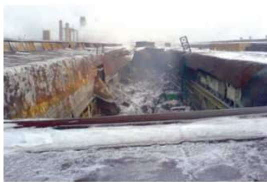
Рисунок 3. Разрушение блока здания ЛПЦ-5 ОАО «Магнитогорский металлургический комбинат»
