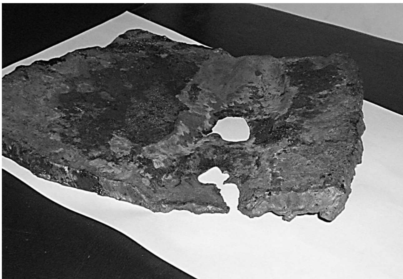
Рис.2.35. Примеры коррозии (истирания стенок) стальных трубопроводов.
