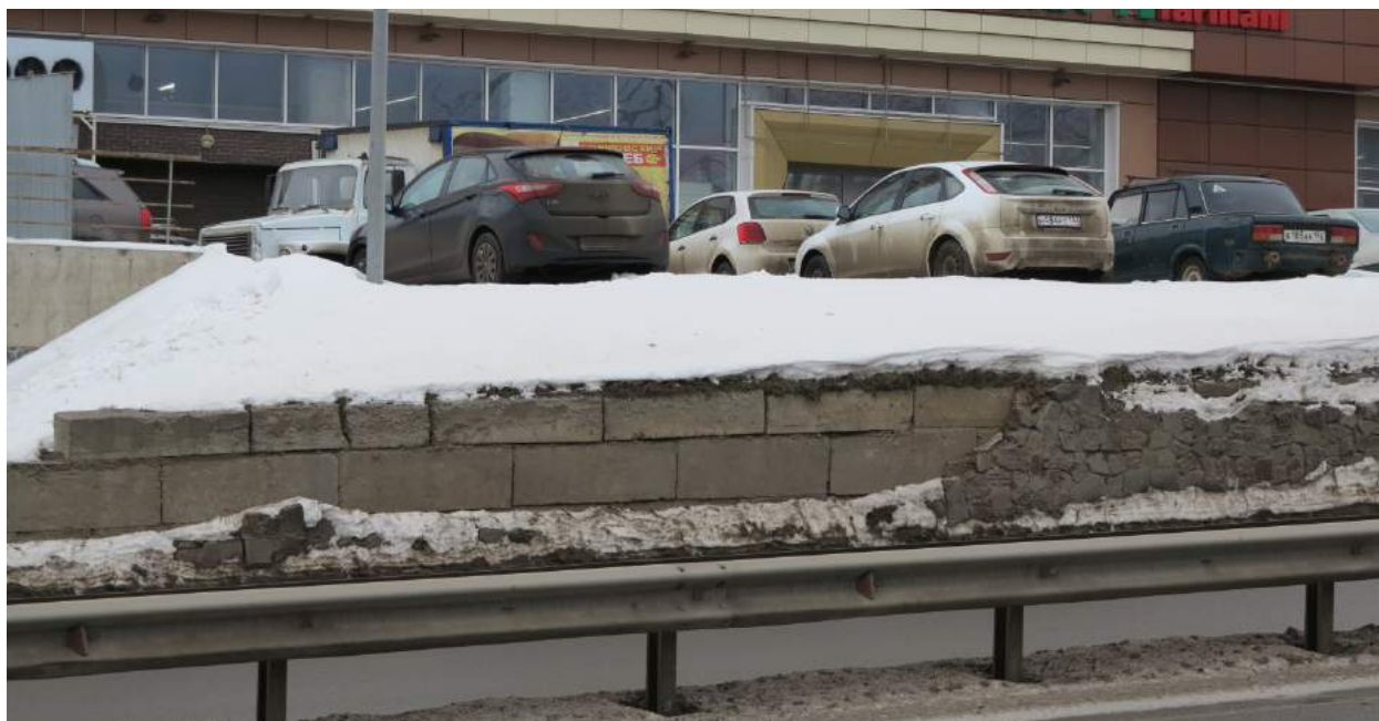
Рис.1. Разрушение декоративной облицовки подпорной стенки из блоков ФБС. Н.Новгород, перекресток ул. Рокосовского и ул. Ванеева
