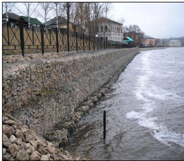
Рис. 25.22. Берегоукрепительные стенки из габионов на Рыбинском водохранилище у г. Весьегонска (2001 г.) и на Камском водохранилище в г. Добрянке (2007 г.)
