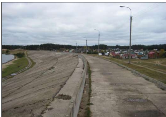
Рис. 25.6. Дамба инженерной защиты пос. Сосновка и Сосновской сельхознизины на левом берегу Чебоксарского водохранилища напротив г. Чебоксар. 2009 г.
