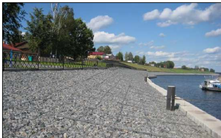
Рис. 25.23. Габионное крепление с упорным поясом из шпунта на надводном береговом откосе Рыбинского водохранилища в г. Мышкине. 2016 г.
