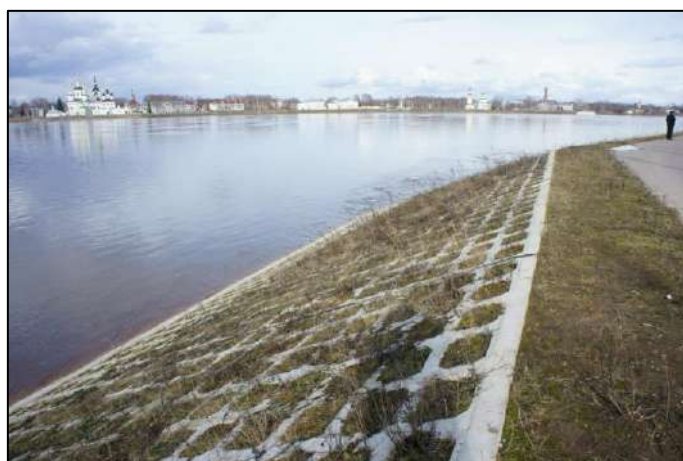
Рис. 25.13. Крепление щебнем в ячейках из железобетона берега р. Сухоны в Дымковской слободе напротив г. Великого Устюга. 2012 г.
