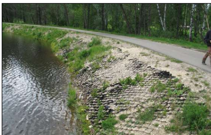
Рис.25.14. Крепление откоса плотины водохранилища Боровое на р. Саровке в г. Сарове ячейстыми полиэтиленовыми панелями с щебеночным заполнителем после 5-летней эксплуатации [589]
