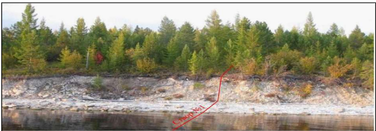
Рис. 16.44. Термоабразионный правый берег Вилюйского водохранилища на участке № 7 в Кусаганском расширении вблизи Усть-Чонской трубы
