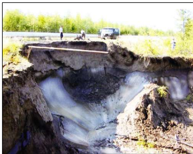
Рис. 16.13. Вытаивающий подземный лед у трассы газопровода в Центральной Якутии [15]
