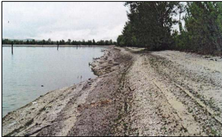
Рис. 29.6. Следы опасного повышения уровня воды в малом водохранилище почти до гребня плотины, оставшиеся на верхнем откосе
