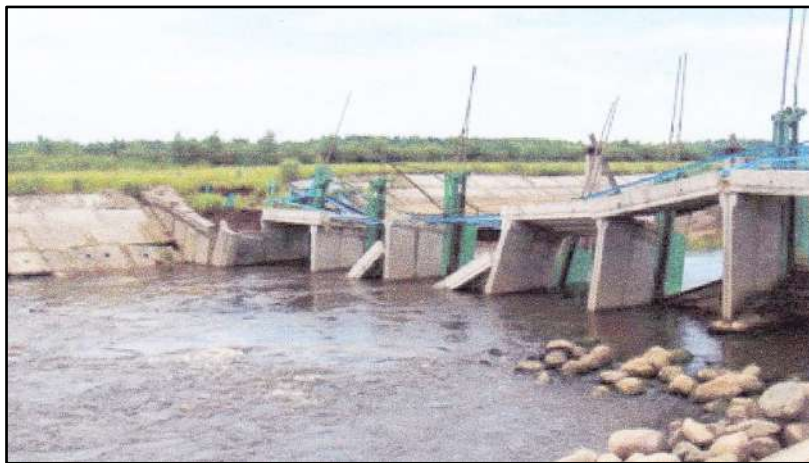
Рис. 29.7. Разрушившаяся водосбросная плотина гидроузла № 3 Тезянской шлюзованной системы на р. Тезе. 2009 г.
