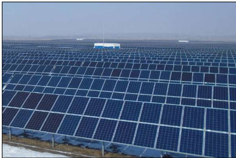
Рис. 3.24. Бугульчанская солнечная электростанция в Башкирии
