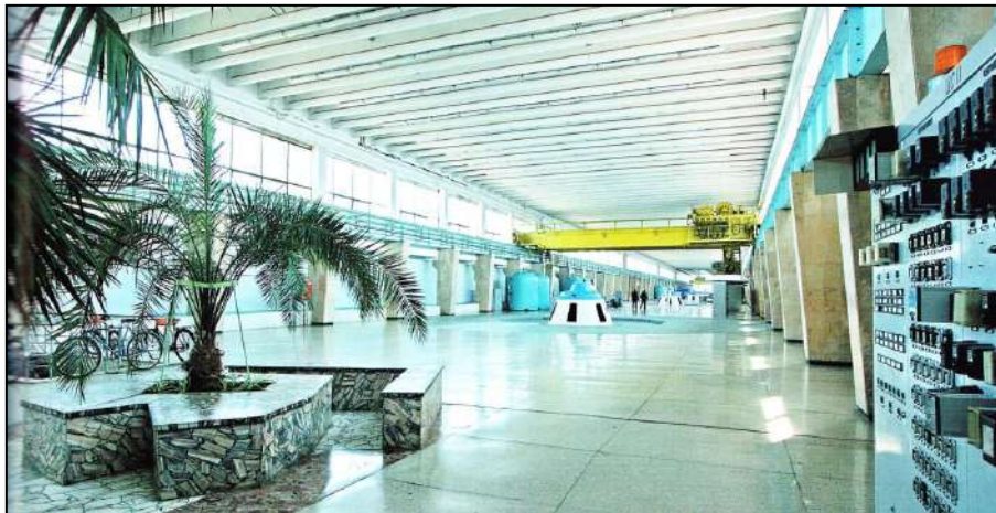
Рис. 8.15. Машинный зал Саратовской ГЭС [108]
