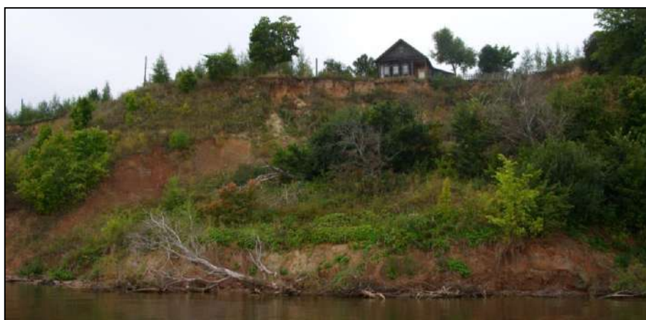
Рис. 14.12. Оползнево-абразионный правый берег Горьковского водохранилища у д. Кулаево
