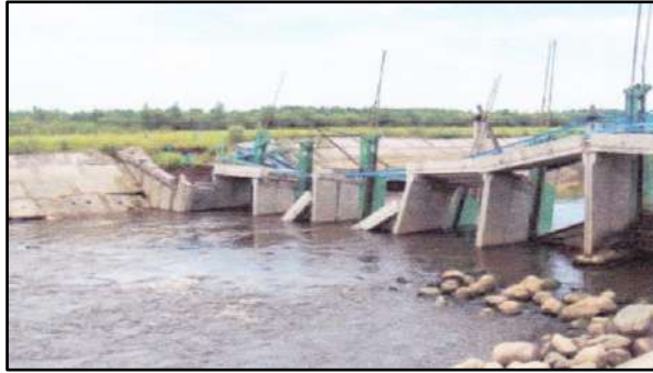
Разрушившаяся водосбросная плотина гидроузла №3 Тезьянской шлюзованной системы на р. Тезе. 2009 г.
