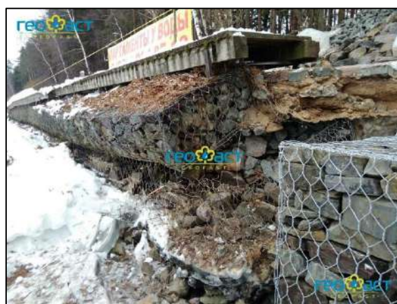
Разрушение берегоукрепительной стенки из габионов
