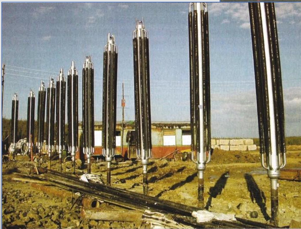
Конденсаторы парожидкостных СОУ на плотине Иреляхского гидроузла после реконструкции замораживающей системы в 2000-е гг.
