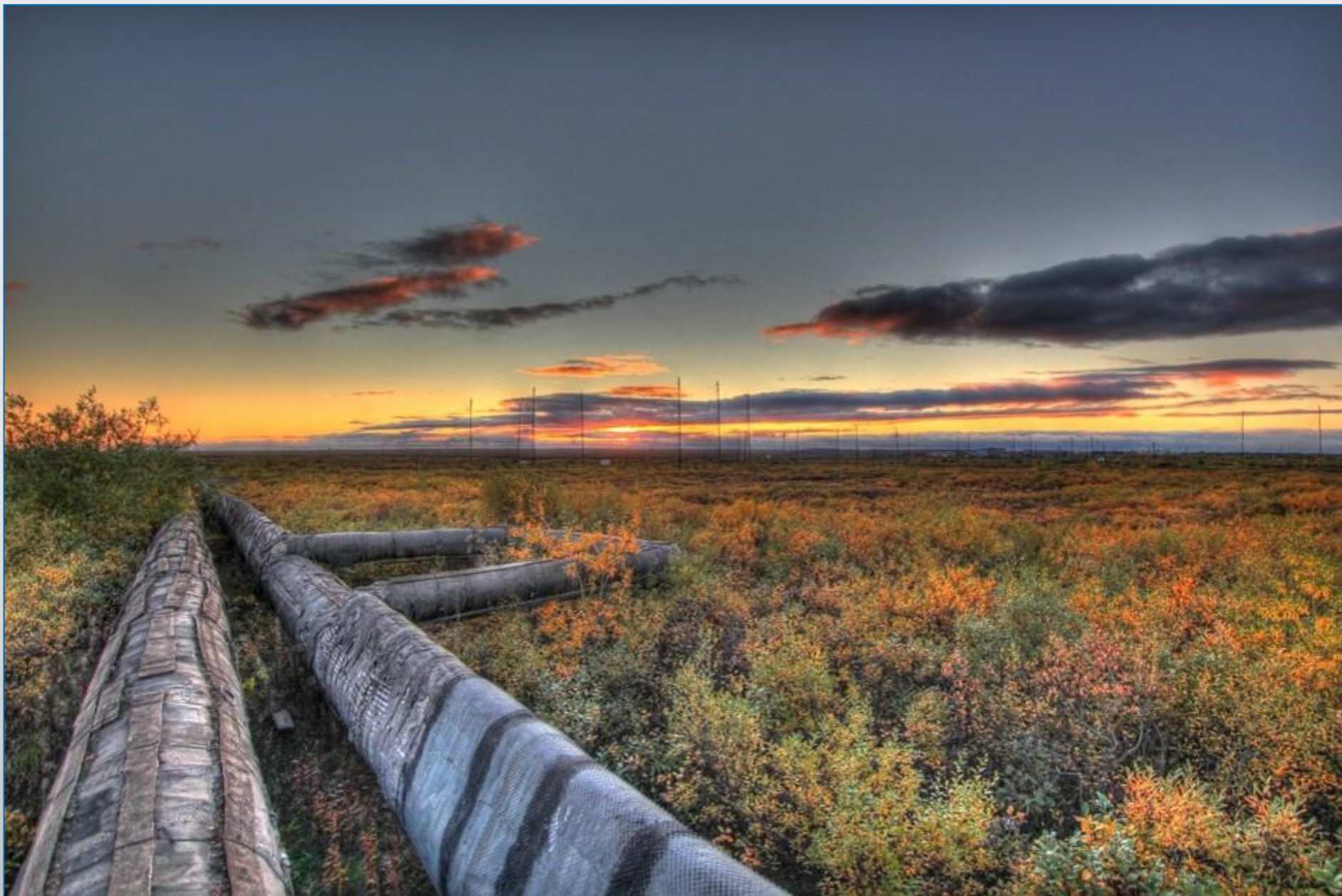
Теплотрасса в промышленной зоне г. Воркуты
