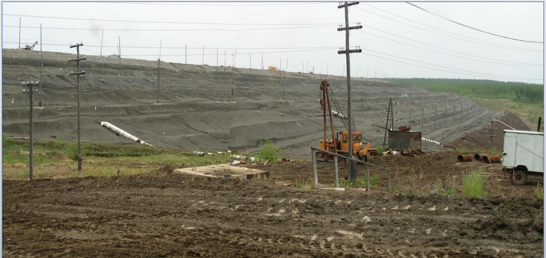
Ограждающая дамба хвостохранилища обогатительной фабрики № 3 Мирнинского ГОК (вид с нижнего бьефа). 2005 г.
