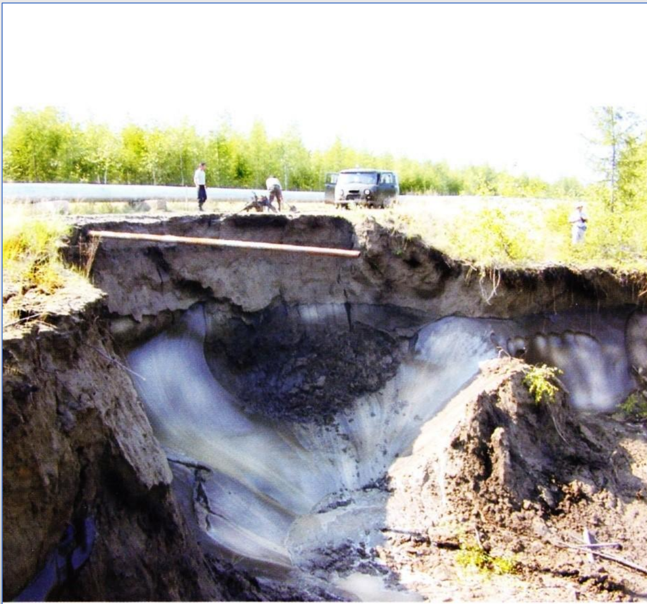
Вытаивание подземного льда на трассе газопровода в центральной Якутии
