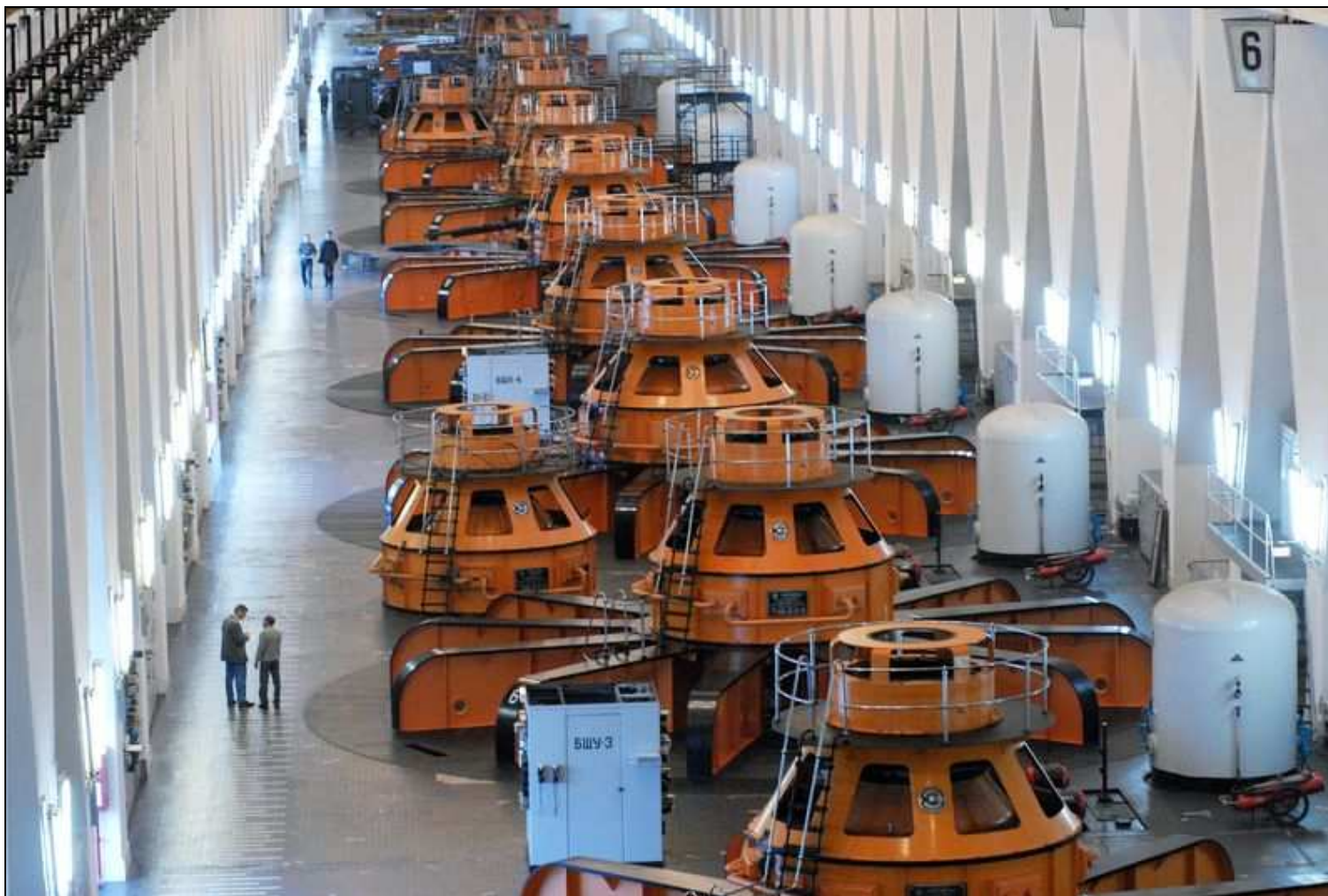
Рис. 49. Машинный зал Братской ГЭС (18 гидроагрегатов)
