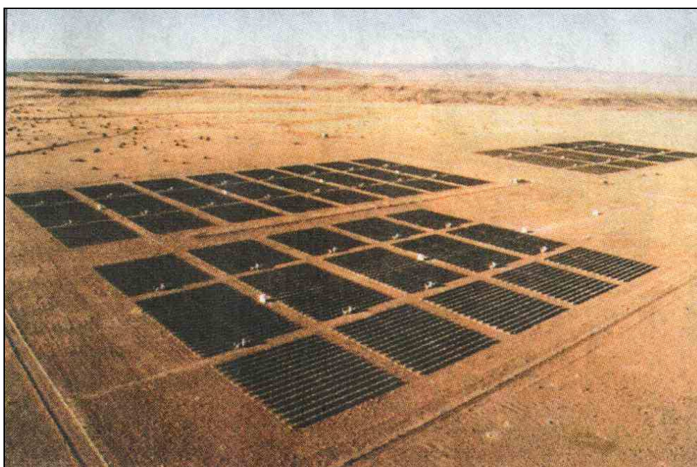
Рис. 83. Солнечная электростанция в пустыне штата Аризона, США: работает с 2008г.; состоит из нескольких миллионов кремниевых элементов; мощность около 20 МВт
