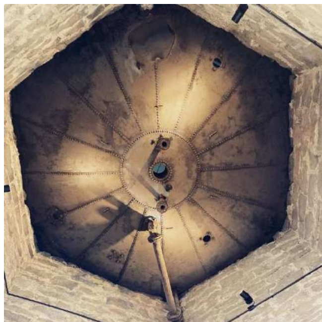
Рис. 3. Дно резервуара башни – вид с 1 этажа
