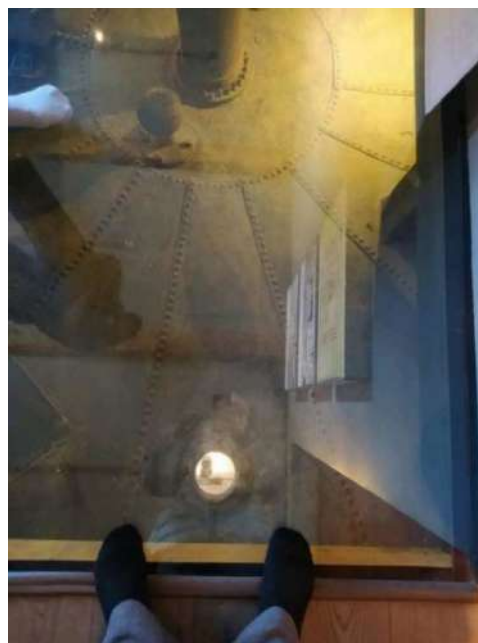
Рис. 4. Дно резервуара башни – вид со 2 этажа
