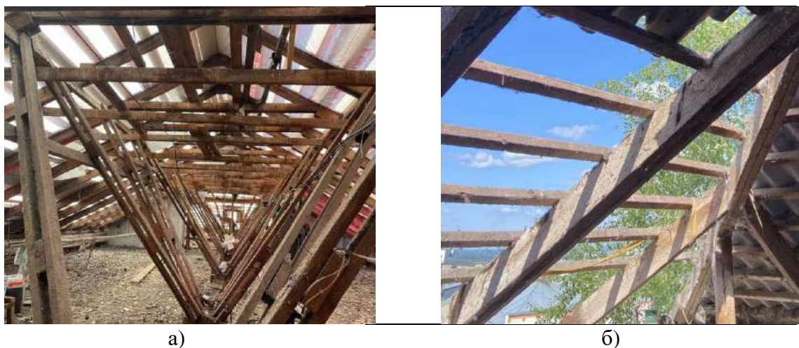
Рис. 1. Оценка показателей качества при визуальном осмотре работ по капитальному ремонту крыши МКД: а) стропильная система; б) демонтированная кровля
