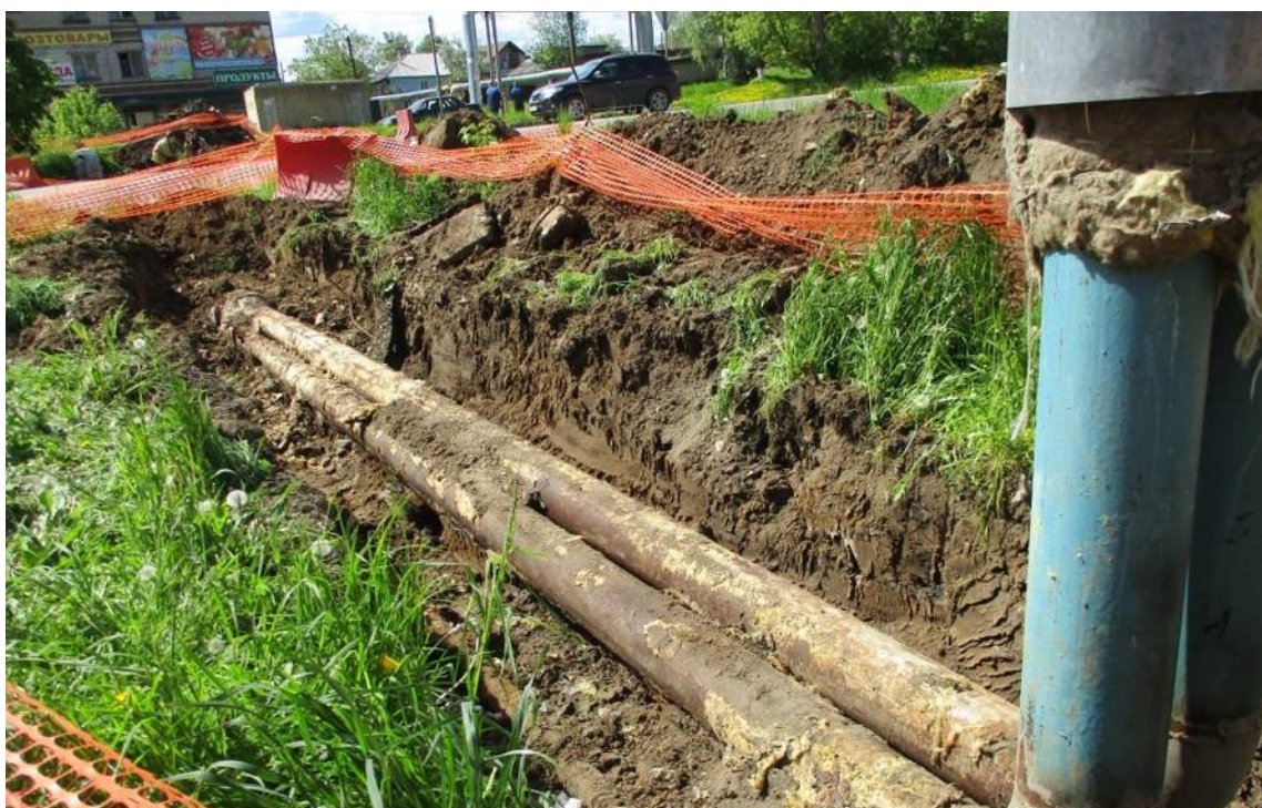
Рис. 2. Нарушение технологии прокладки теплопроводов
