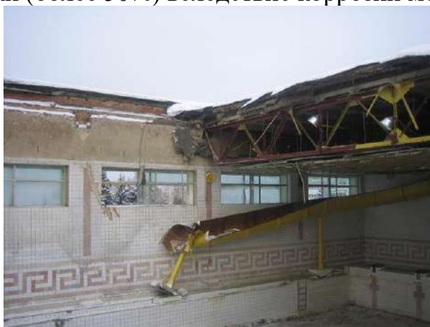
Рис.1 Последствия обрушения покрытия бассейна «Дельфин» в г. Чусовом
