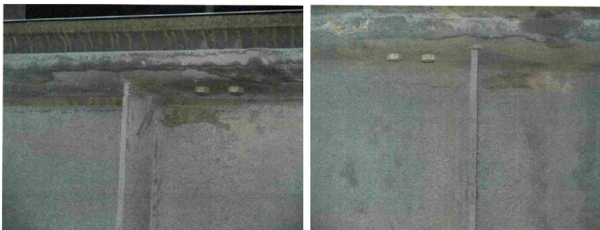
Фото 1. Продольные трещины в сварном шве, соединяющем верхний пояс и стенку сварной подкрановой балки, установленной в цеху выксунского металлургического завода
