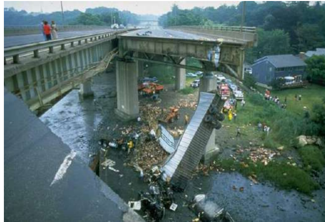
Рис.2 Последствия обрушения моста через реку Мианус в Гринвиче, США
