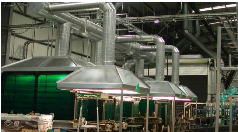
Рис. 1. Эффективная система вентиляции сварочного цеха
