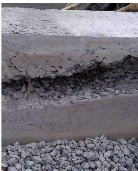
Рис. 2. Пустоты в теле бетона
