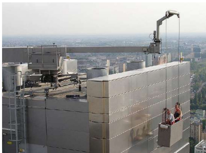
Фото 1. Подъемники для чистки фасадов
