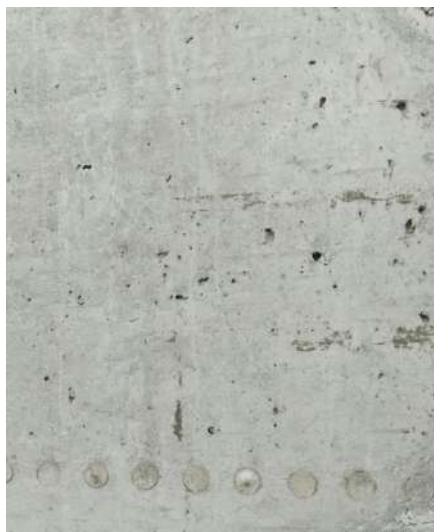
Рис. 1. Полости на поверхности бетона
