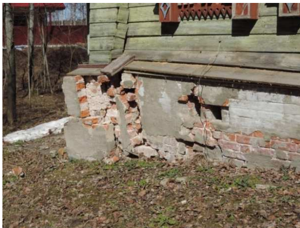
Рис. 1. Состояние цоколя (фото автора, апрель 2019 г.)
