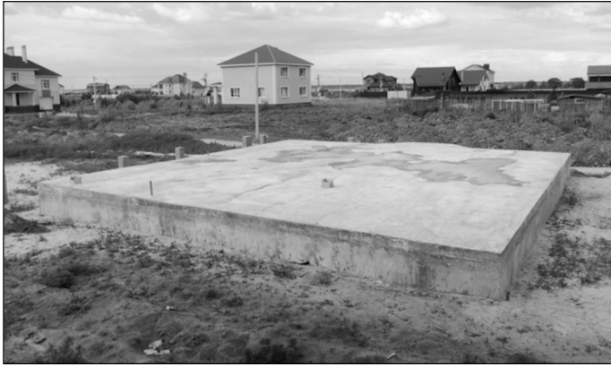
Рис. 2. Монолитная железобетонная плита, выполненная по верху ростверков, опирающихся на буронабивные сваи (см. рис. 3)
