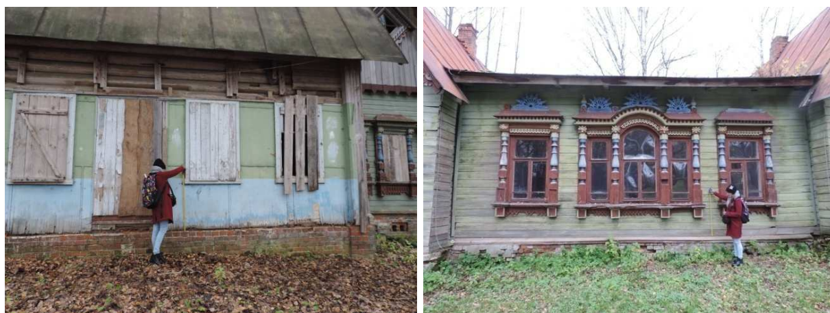
Рис. 2. Состояние стен (фото автора, октябрь 2019 г.)
