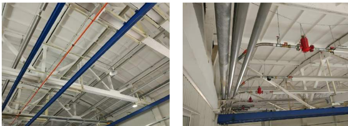
Рис. 2. Водяные низкотемпературные инфракрасные излучатели, установленные в производственном помещении
