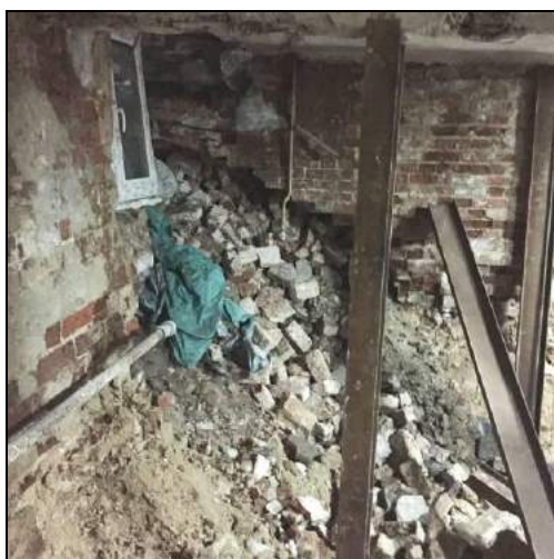
Фото.4. 29 октября 2015 г. Подвальное помещение в осях «А-Б»/«3-4». Разрушение кирпичных фундаментов в углу под стенами на пересечении осей «А»/«4».
