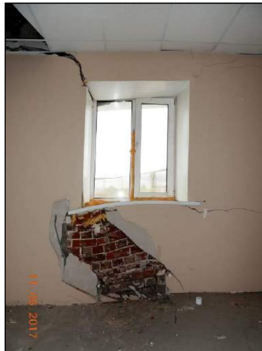
Фото.3. 3-ий этаж. Наружная стена, ориентированная по оси «А»/«1-2». Разрушение подоконного пояса.
