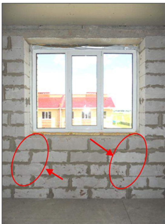
Фото.1. 2-ой этаж. Наружная стена, ориентированная по оси «А»/«1-2». Трещины в несущей части стены из газосиликатных блоков.
