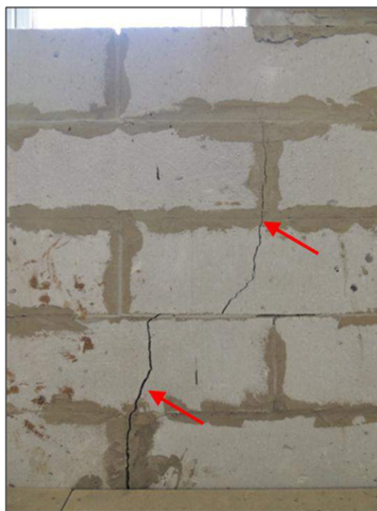
Фото.2. 2-ой этаж. Сквозные трещины в кладке подоконного пояса наружной стены, ориентированной по оси «А»/«1-2».
