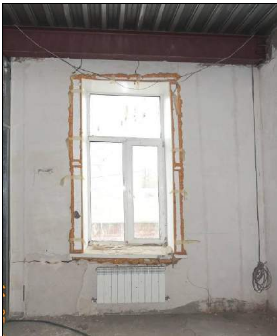
Фото.2. 2-ой этаж. Деформация и разрушение наружной стены, ориентированной по оси «4», на участке в осях «А-Б».
