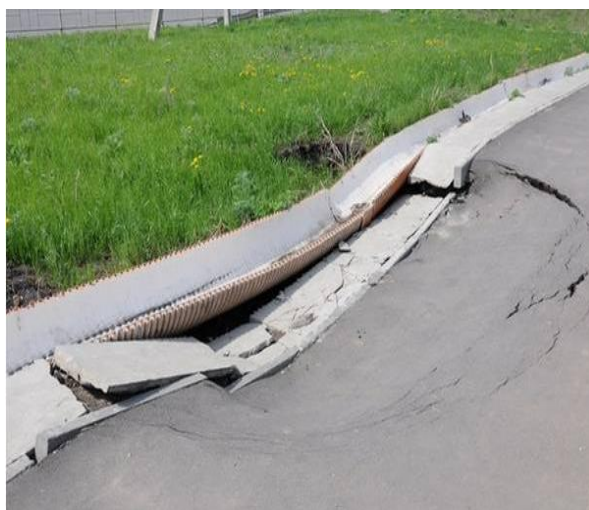
Разрушение пешеходной дорожки в районе ул. Богдановича
