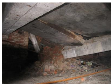
Рис.2. Участок обрушения, вид в осях «Б-В»
