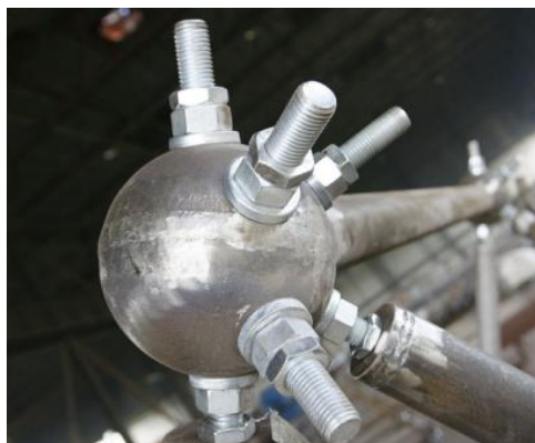
Рис. 4. Коннектор системы «БрГТУ»
