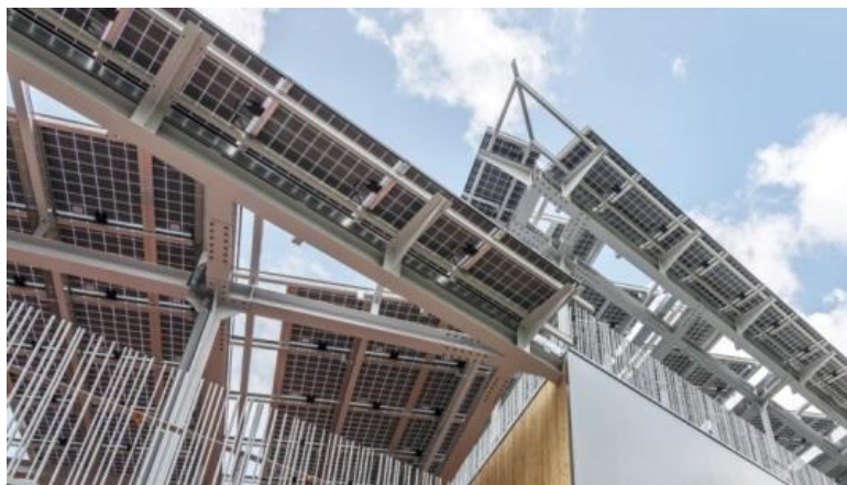
Рис. 2 Начальная школа Zero Energy, Сент-Уэн, Франция. Фотоэлектрические солнечные панели
