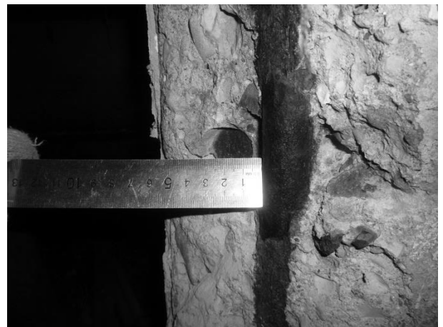
Рис. 2. Пример участка исследования коррозионного состояния железобетонной колонны. По результатам исследования установлено, что карбонизации подвергся весь защитный слой бетона арматуры
