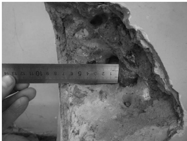
Рис. 1. Пример участка исследования коррозионного состояния железобетонной колонны. По результатам исследования установлено, что карбонизации подверглась только часть защитного слоя бетона арматуры на величину до 25 мм
