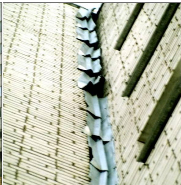
Рис. 3. Сентябрь 1997 года. Разрушившийся в результате чрезмерного крена секции № 2 нащельник из оцинкованной стали
