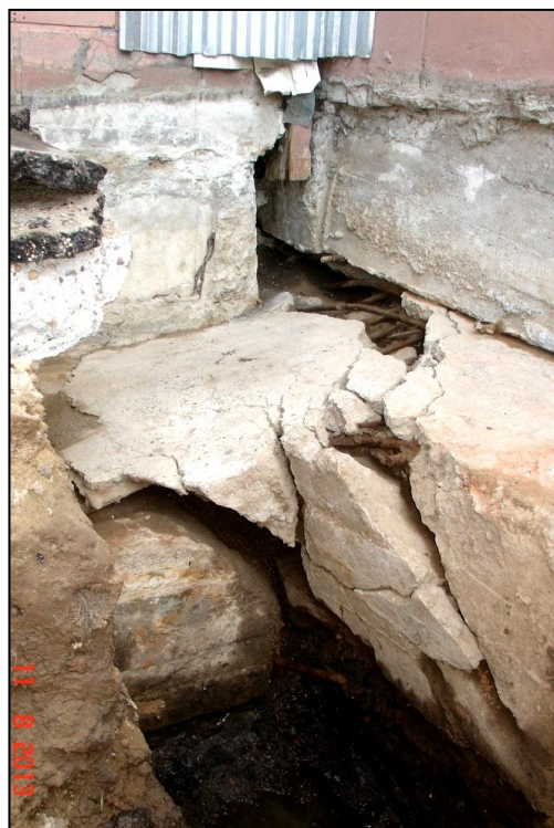
Рис. 5. Разрушение фундаментной плиты у температурного деформационного шва, отделяющего секцию № 1 от секции №2
