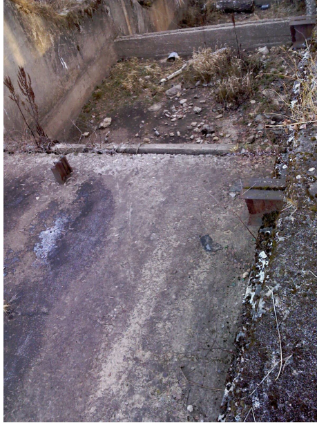
Рис. 4. Разрушения стыков железобетонных элементов
