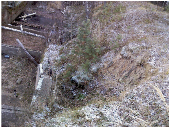
Рис. 5. Провал грунта в месте сопряжения плотины с перепадом
