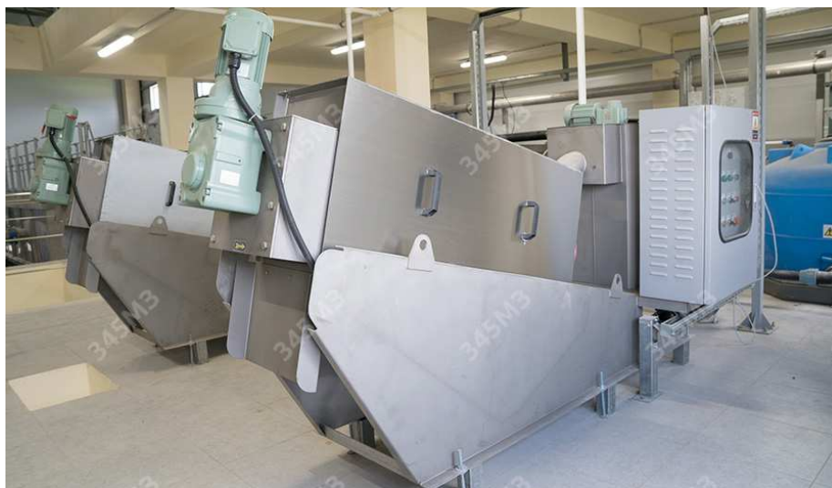
Рисунок 1 - Шнековые установки обезвоживания осадка
