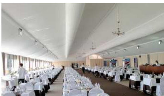
Рисунок 1 – Применение текстильных воздуховодов в большом ресторанном зале
