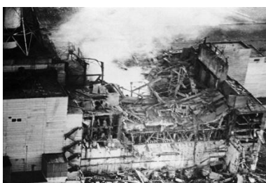
Рис. 2. Разрушения на 4-м реакторе ЧАЭС
