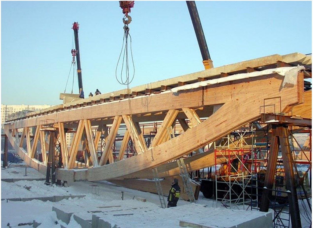
Рис. . Вариант решения большепролетной сегментной фермы. Перекрываемый пролет 60,0 метров. Высота фермы 6,0 метров
