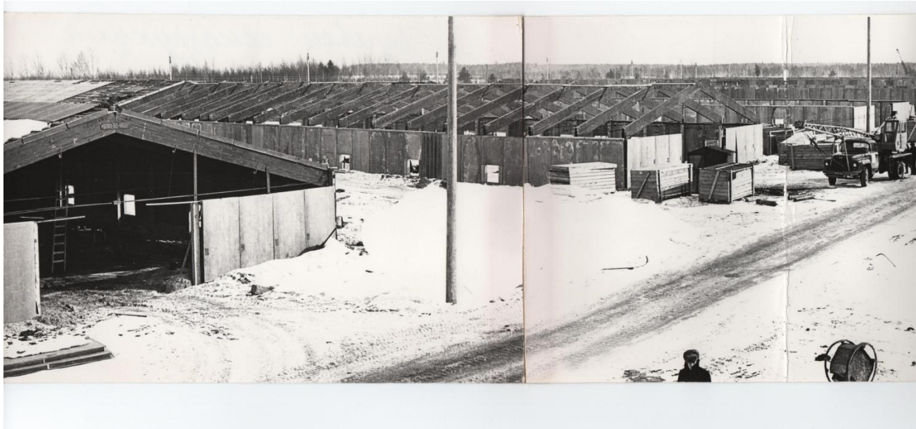
Рис.6.3. Пример применения треугольных «арок» при строительстве птичников на Сеймовской птицефабрике в Нижегородской области.
