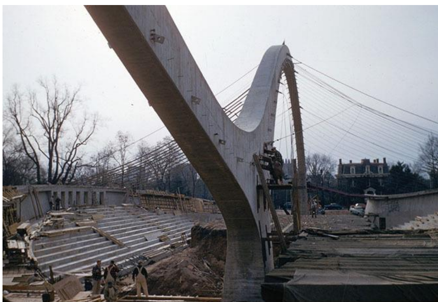
Рис. 1.29. Строительство хоккейного стадиона "Ингаллс Ринк" с висячим вантовым покрытием Йельского университета в Нью-Хейвене, Коннектикут, США (1953–1959)
