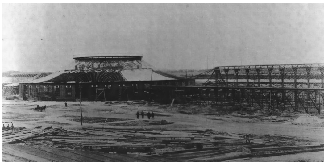
Рис. 31. Всероссийская промышленная и художественная выставка в Нижнем Новгороде, 1896 г. Ротонда и прямоугольный выставочный павильон в период строительства
