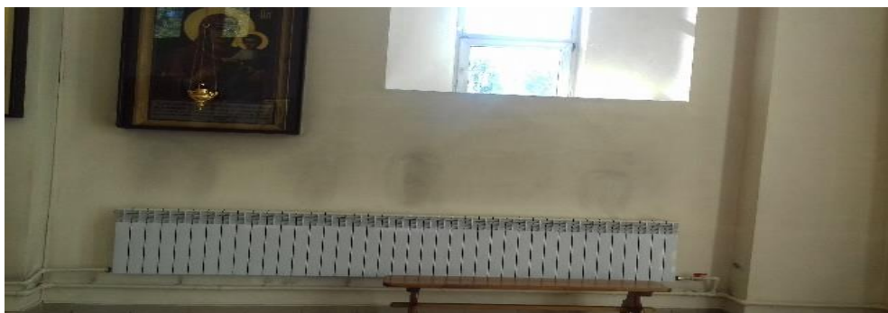
Рис. 1. Общий вид загрязнения внутренней поверхности стены и икон над отопительным прибором.
