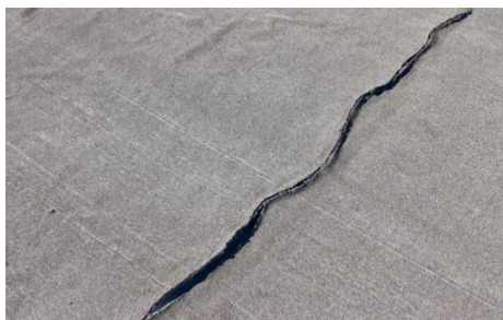
Рис. 58. Локальные повреждения плоской кровли
