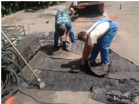
Рис. 59. Обширное повреждение битумной кровли
