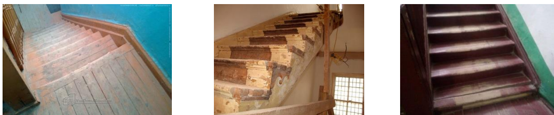
Рис. 68. Примеры повреждения лестниц.
