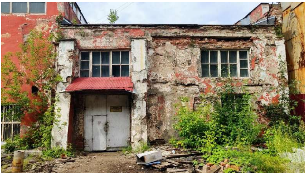
Рис. 4 - Участок кирпичной стены с дефектами и повреждениями
