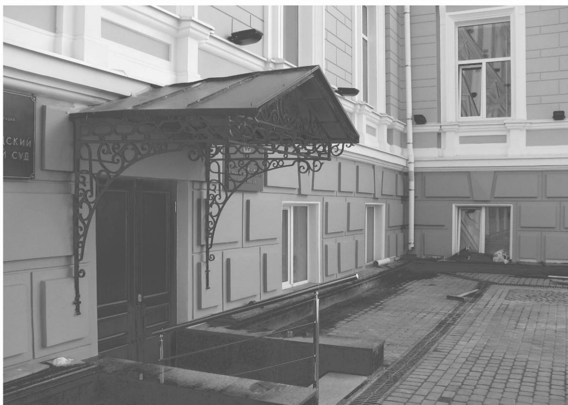
Рис. 8. Виды металлической калитки ограды (вверху) и металлического козырька бокового входа (внизу) после реставрации. Фото 2010 г.
